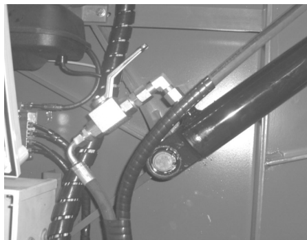
Sikringsventil pressekamerer høyre side, ventil i åpen posisjon
